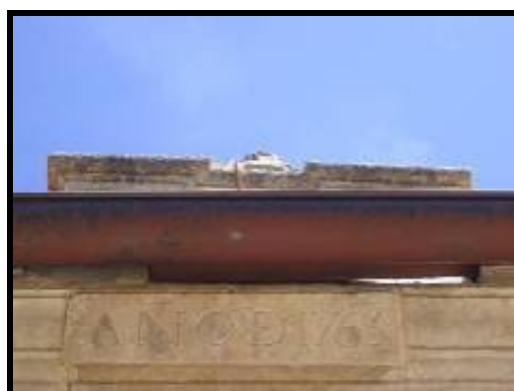
Fecha, varilla, declinación del muro.
