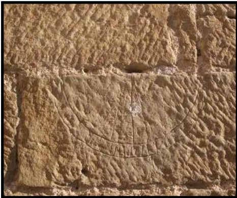
Reloj 4. Muy deteriorado
